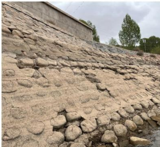
进口右侧边墙局部破损
