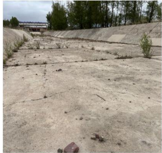
溢洪道结构老化、局部破损
