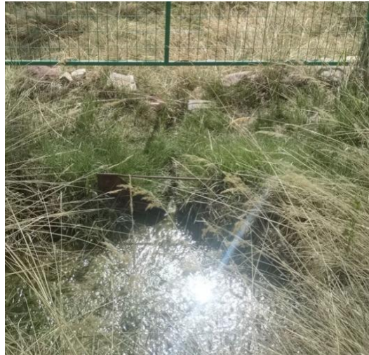
东坝段下游坝脚渗水
